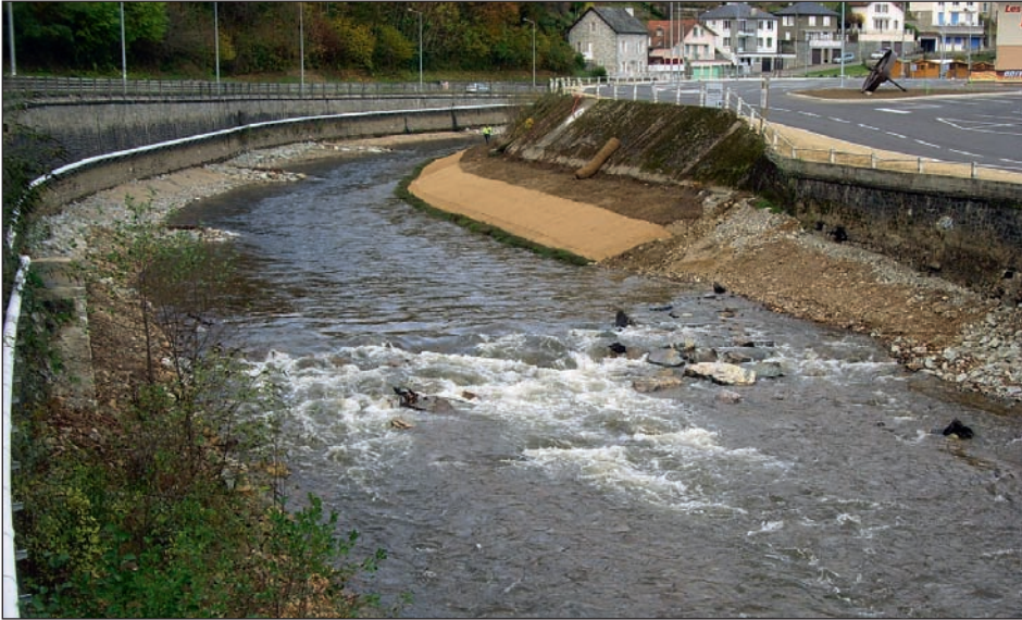
Fig. 8 : Vue de l'ensemble des aménagements réalisés en fin de travaux : seuil arasé et rampe en enrochement, épis en extrados de courbure et génie végétal en intrados (photo Biotec).
