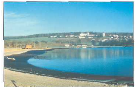
Figure 1 : (25.01.01) Etat des étangs à la fin des travaux de génie civil avec la mise en place d'une étanchéité bitumineuse.
