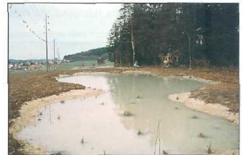
Figure 12: (10.03.99) Etat à la fin des travaux après la plantation des hydrophytes et des héliophytes et juste après la mise en eau; on remarque la forme irrégulière de l'étang qui permet d'augmenter le linéaire d'interface eau/terre (écotone).
