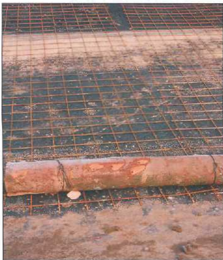
Figure 4: (27.02.01) Détail de la mise en place des rondins de bois en pied de talus sur les berges présentant des pentes supérieures à 2:3 de manière à empêcher les matériaux terreux de fluier dans l'étang lors de sa mise en eau.
