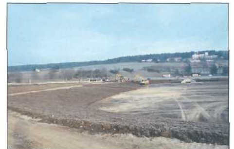
Figure 2: (02.02.01) Mise en place d'une couche de matériaux terreux uniquement sur les parties en pente.
