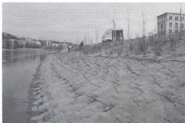
Fin des travaux portant sur plus de 600 m de berge. Une répartition des ligneux a été opérée selon les séries végétales observables sur le Rhône (14.3.1994).
