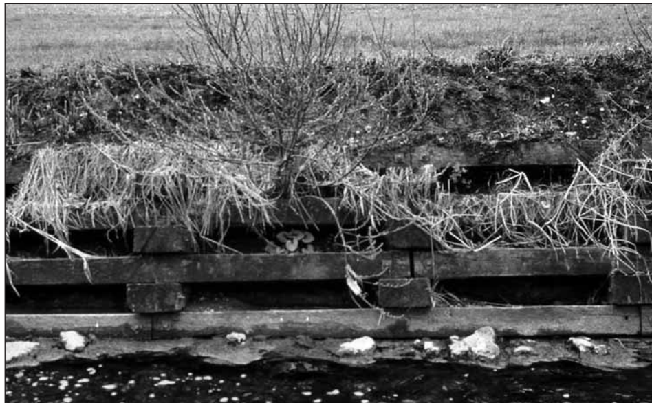
Fig. 5: Stabilisation d'une berge de cours d'eau avec des traverses de chemin de fer, style «Kraierwand». On voit tout de suite les limites de ce genre de construction par l'érosion systématique des matériaux contenus dans l'ouvrage. Ceci ne permet pas la croissance des végétaux et est inadapté sur certains cours d'eau (Photo Biotec).
