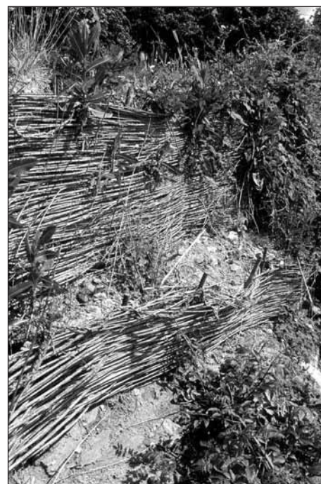
Fig. 12: Le génie biologique mal conçu, utilisant pourtant le végétal pour stabiliser des talus, peut aussi parfois s'avérer complètement farfelu et incompréhensible. Ces tressages de quelque 1.30 m de hauteur sont logiquement morts et présentent une déficience importante de résistance (Photos Biotec).
