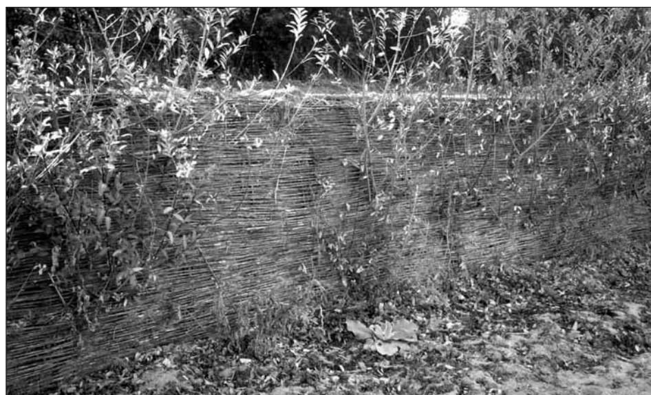
Fig. 11: Le génie biologique mal conçu, utilisant pourtant le végétal pour stabiliser des talus, peut aussi parfois s'avérer complètement farfelu et incompréhensible. Ces tressages de quelque 1.30 m de hauteur sont logiquement morts et présentent une déficience importante de résistance (Photos Biotec).
