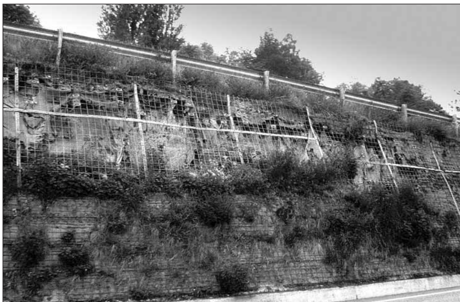
Fig. 6: Système de stabilisation de talus n'ayant pas donné toutes ses promesses. L'ouvrage se vide et les végétaux ne peuvent pas croître (Photo Biotec).
