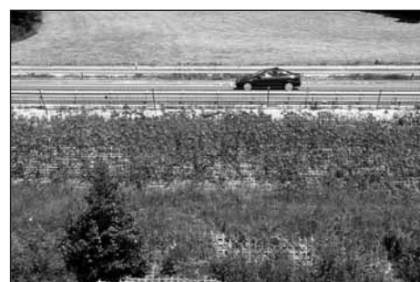
Fig. 8: Deux systèmes montrent ici des risques inquiétants de mauvais fonctionnement écologique et paysager. Le talus externe de la route est un système fait d'armature métallique. Après cinq ans, la végétation n'est pas développée et la structure est toujours visible, enlaidissant le paysage. Le 2 ème système, à gauche, est constitué de dalles ajourées (dalles-gazon) tapissant la berge d'un ruisseau. L'artificialisation du site est très forte, les végétaux se développent très mal. Les fonctions techniques sont peut-être réalisées mais les fonctions paysagères et écologiques sont médiocres (Photo Biotec).
