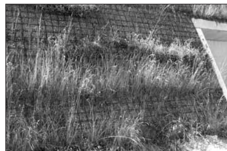
Fig. 7: Les systèmes brevetés, souvent très verts dans les publicités, donne l'illusion d'un ouvrage bien intégré. Si techniquement le système peut paraître efficace en terme de stabilisation, les aspects écologiques et paysagers ne sont pas intégrés. Ici les plantes ne poussent que dans les jointures entre les étages (Photo Biotec).
